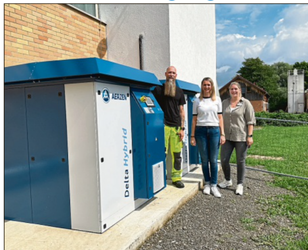
Bürgermeisterin Sina Massow (m.) lässt sich die neuen Drehkolbengebläse in der Kläranlage von Marco Thormann (Kläranlage) und Hannah Puntschuh (Stadt Gudensberg) zeigen.
